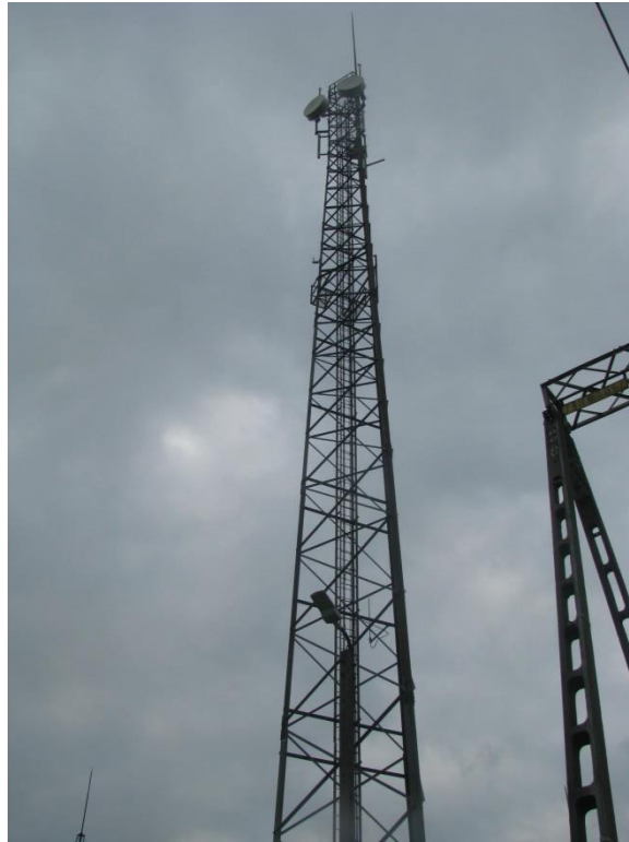
Zał. nr 1: Widok ogólny instalacji radiokomunikacyjnej.
