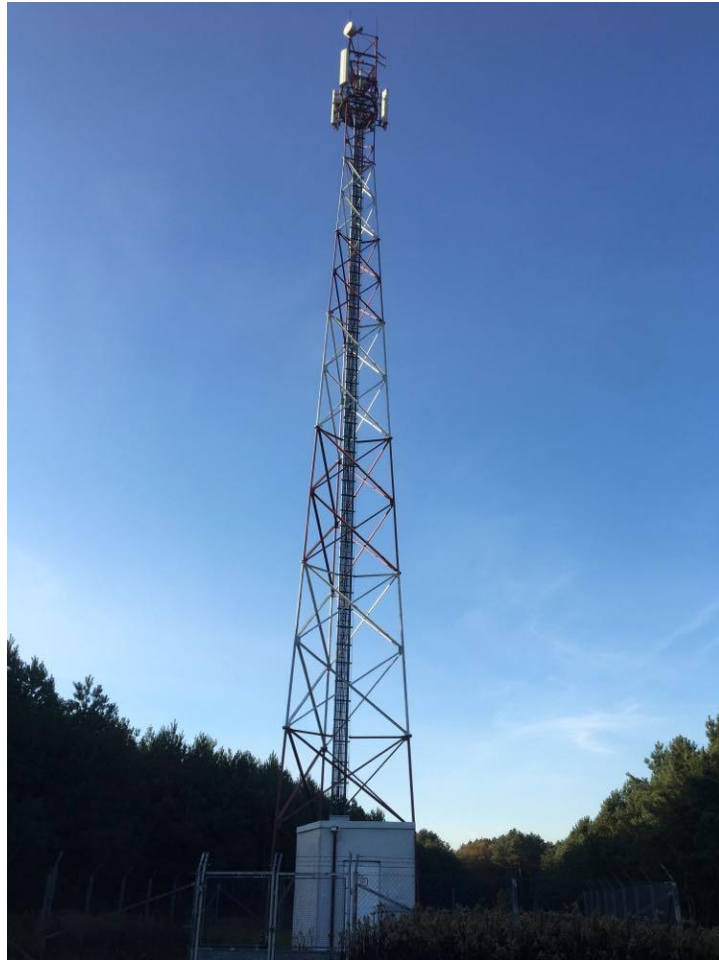
Zał. nr 1: Widok ogólny instalacji radiokomunikacyjnej.
